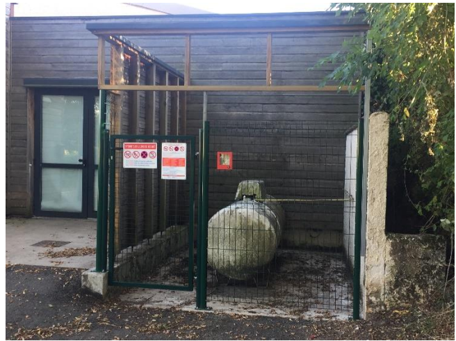
Suite à plusieurs rappels de non-conformité du local, nous avons procédé aux modifications demandées (Partie grillagée obligatoire, boîte à clés, paroi coupe-feu).
